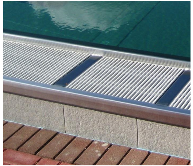
Figure 16 - Goulotte de débordement surélevée
